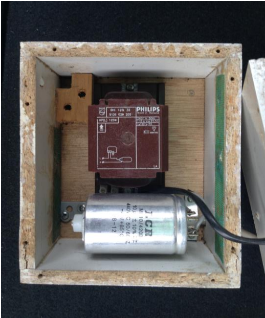
Fig. 7. Volledig gemonteerd systeem met ballast en condensator (deksel verwijderd). © Theo Garvevoet.
